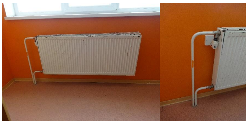
Obr. 5 Vykurovacie oceľové doskové telesá s temostatickým ventilom a termostatickou hlavickou.
