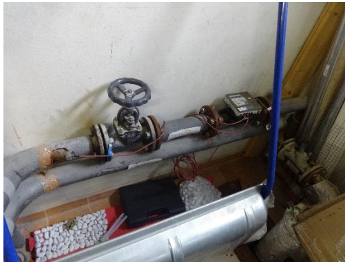
Obr. 2 Prívodné a vratné potrubie teplovodu s ventilom a meračom tepla v technickej miestnosti budovy Telocvične pri ZŠ Strečno.
