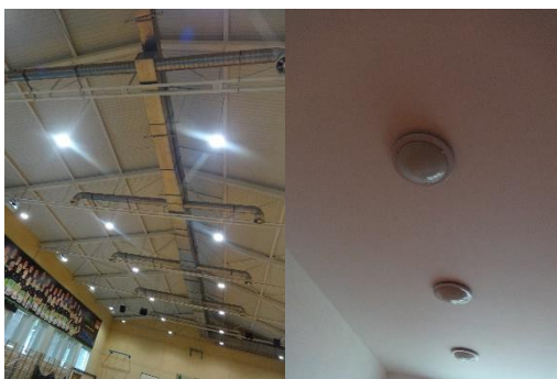
Obr. 7 Svietidlá v budove
