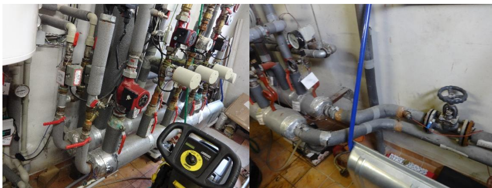
Obr. 6 Rozdelovač a zberač, prívod teplovodného potrubia s ventilom.
